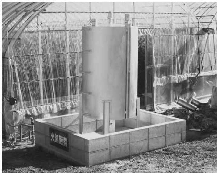
防油堤の設置は早急な対策が必要
