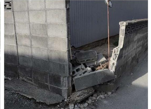
地震によりブロック塀の一部が損壊
