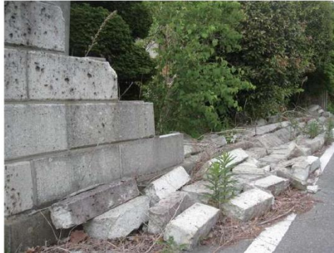
地震により石塀が倒壊
