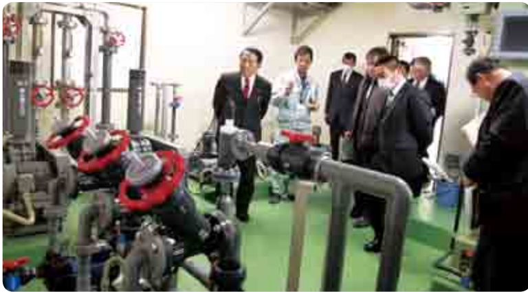
古屋 宮ノ前農業集落排水
