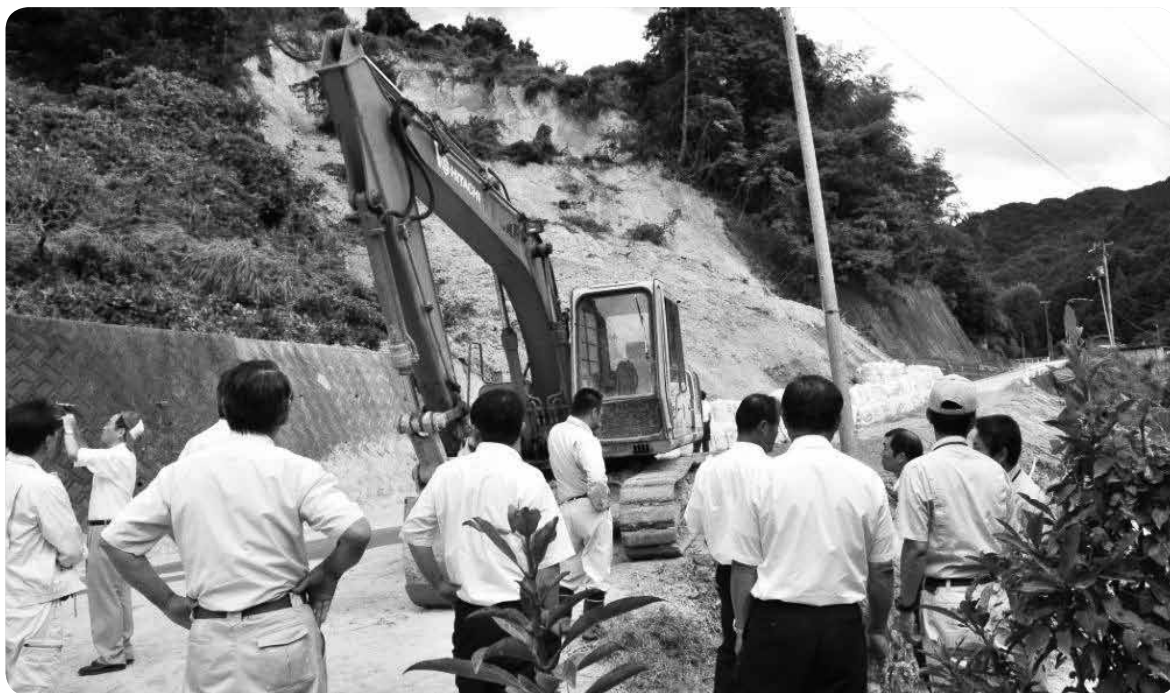
町道櫻川田辺線の大規模崩土
