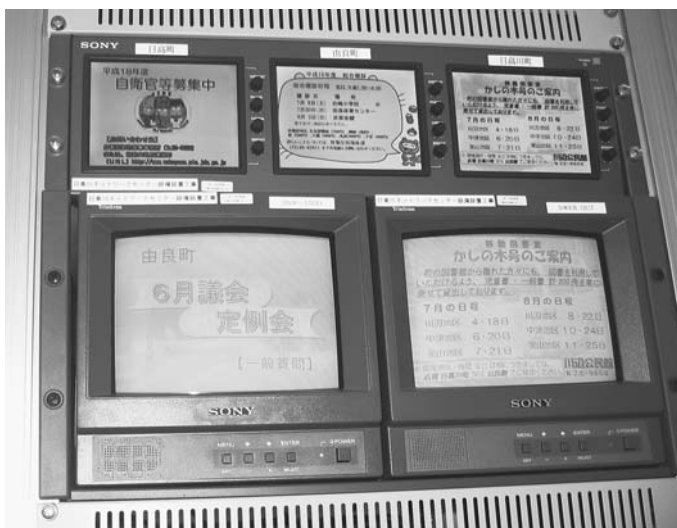
某局のケーブルテレビシステム
