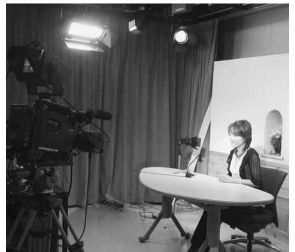
ケーブルテレビ放送設備
