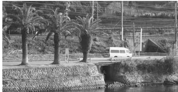
津波対策としての護岸改善を・・・
