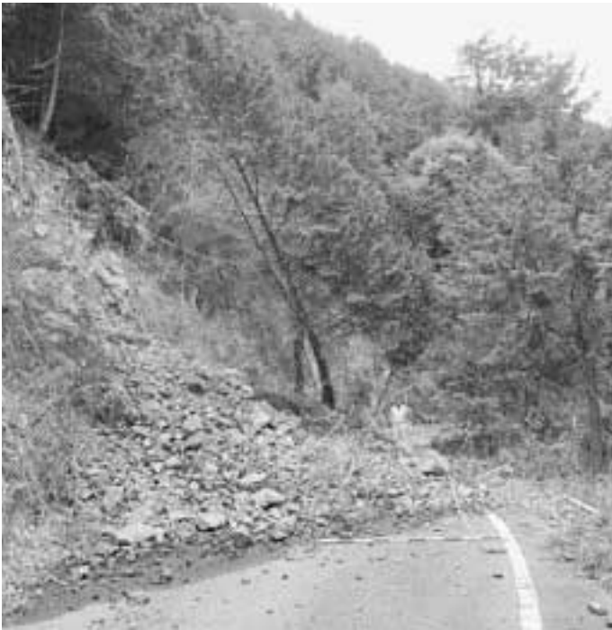
野々古川又林道の崩土現場
